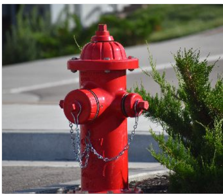
Hidrante de columna
